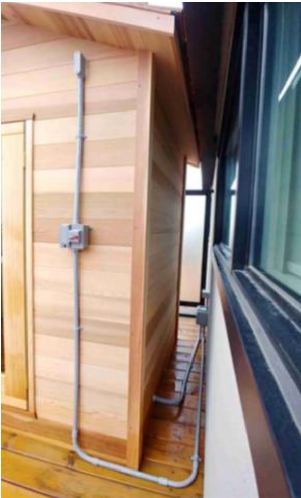
Weatherproof Conduit & Light Switch
