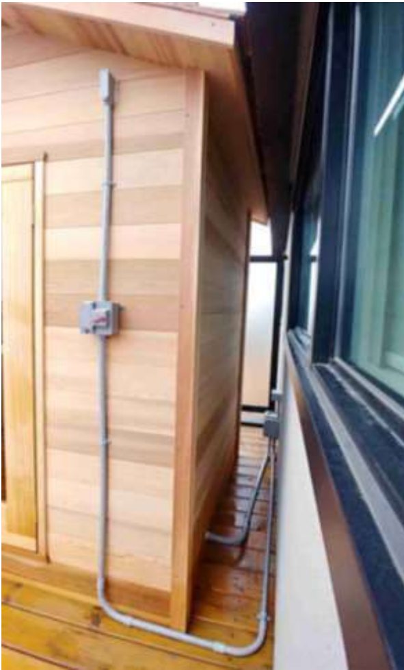
Weatherproof Conduit & Light Switch
