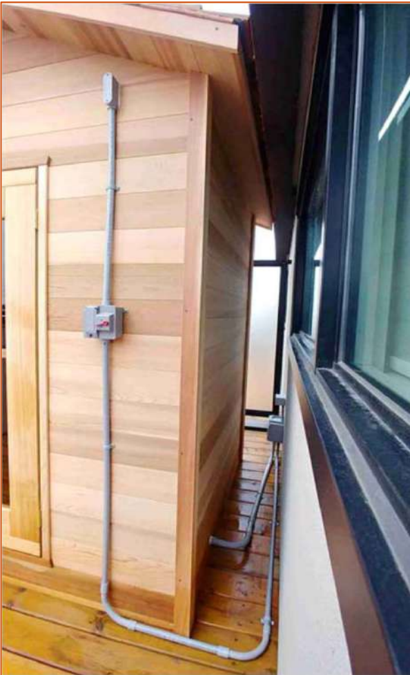
Weatherproof Conduit & Light Switch
