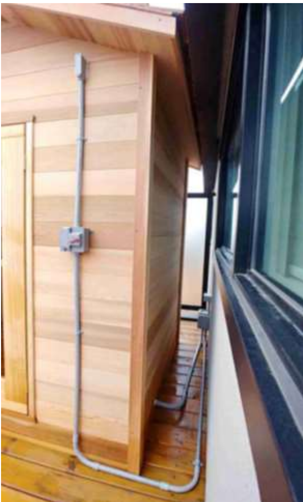
Weatherproof Conduit & Light Switch
